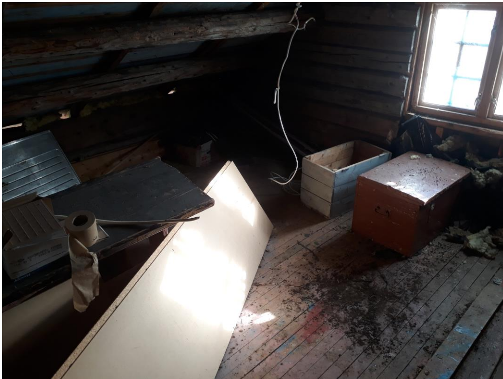
Flaggermusavføring på gulvet i gamle skolen i Vanvikan. Foto:Jurgen Wegter
